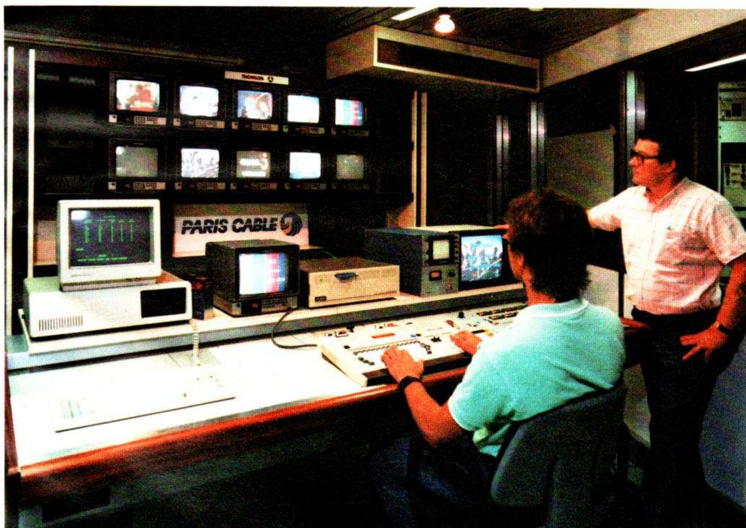
Une salle de contrôle de Paris Câble.
